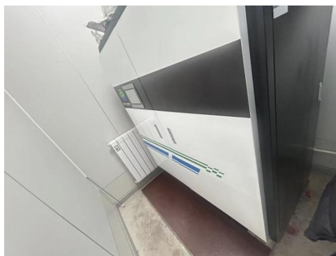
废水处理装置
